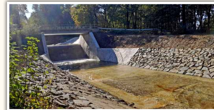
Přivaděč Vyšní Lhoty–Žermanice, stupeň 16
