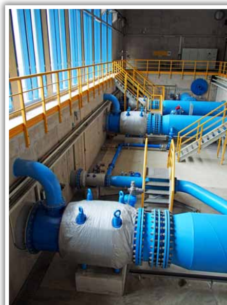
Strojovna spodních výpustí a MVE
