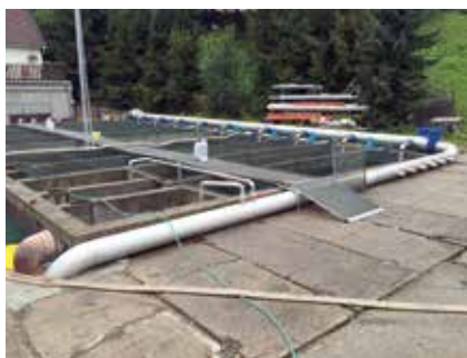
RH Žermanice rozvody vody
