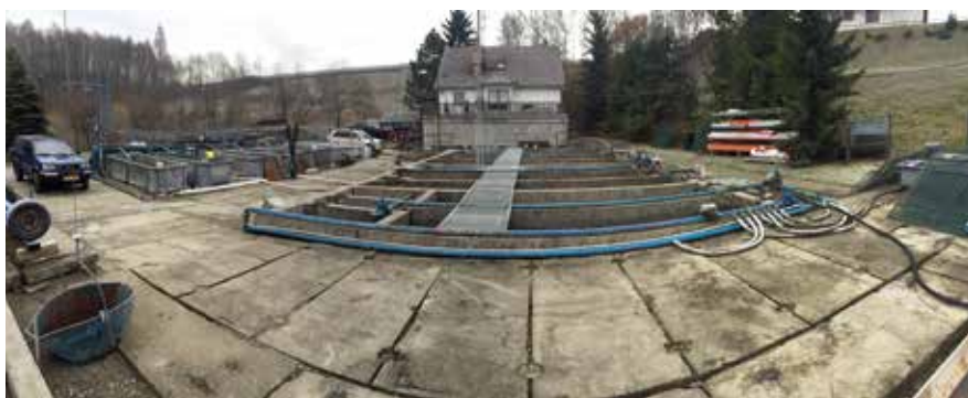
RH Žermanice rozvody původní 1
