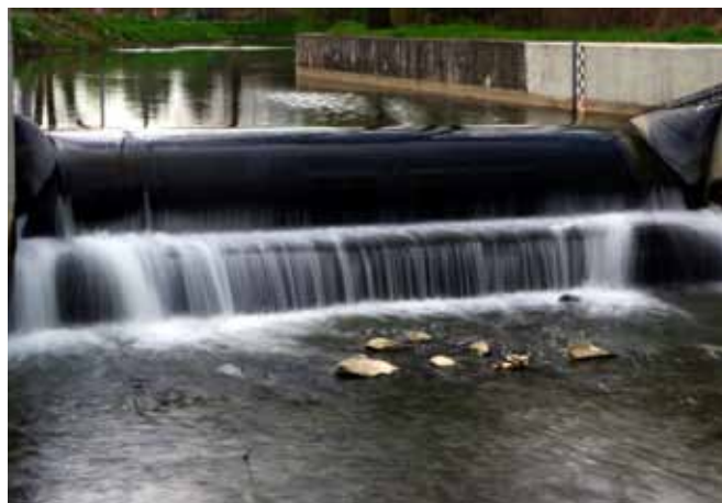
Jez na Porubce – hrazení v podobě pryžotextilního vaku
