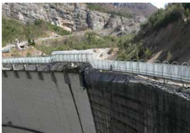
Vajont – koruna hráze s poškozením v levém zavázání
